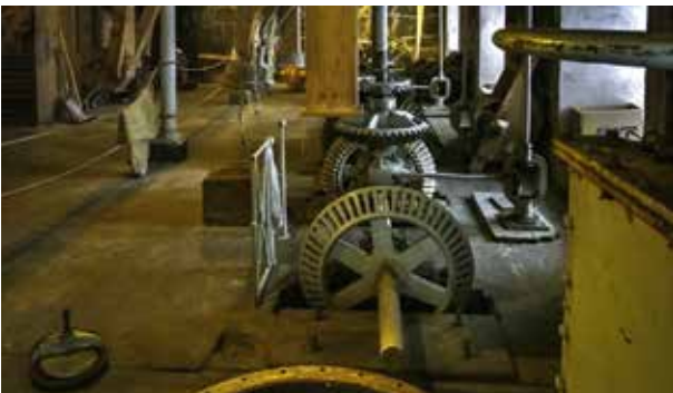
Vattenturbinen som driver kraftöverföring och kvarnspel.
