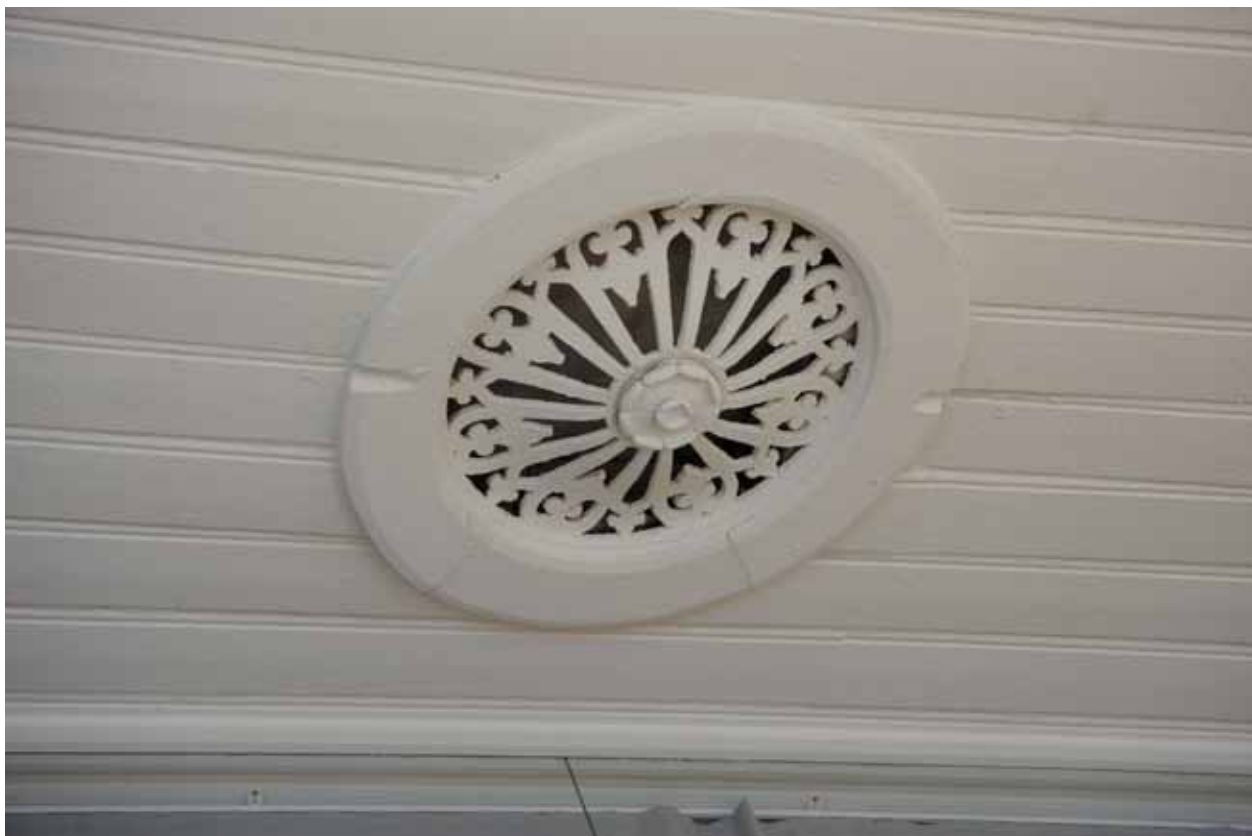
DEKORATIVT VENTILATIONSGALLER I GYMNASIKHUSET, HUS 6, FRÅN 1880-TALET. FOTO J. MALMBERG.
