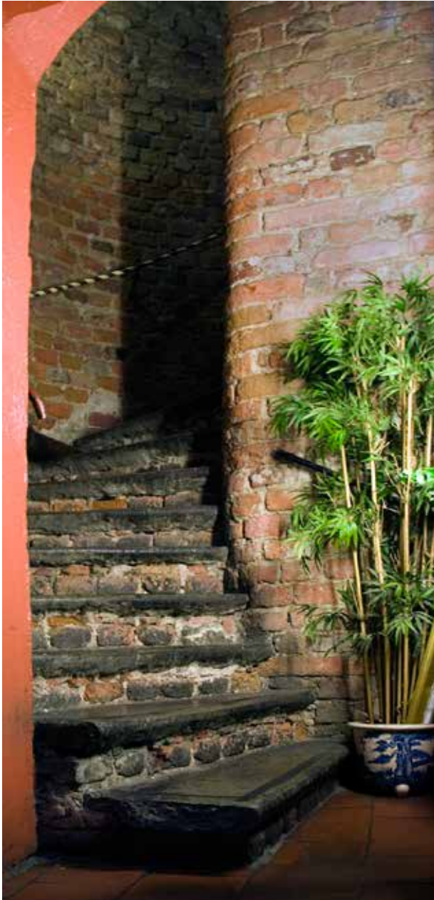
TRAPPAN FRÅN KÄLLAREN TILL BOTTENVÅNINGENS FÖRSTUGA HAR PLANSTEG AV KALKSTEN. MURVERKET ÄR AV SAMMA TYP SOM I BOTTENVÅNINGEN OCH TRAPPAN BÖR HA UPPFÖRTS 1863. FOTO: J. MALMBERG.
