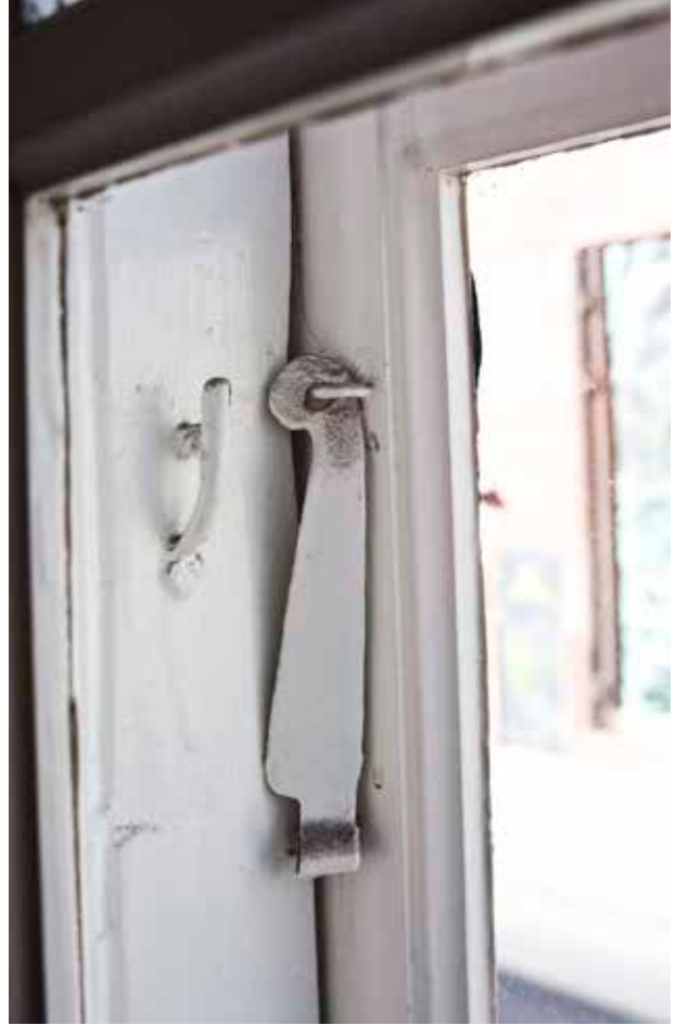
FÖNSTERHASP AV EN TYP SOM VAR VANLIG UNDER 1700-TALET. FOTO J. MALMBERG.
