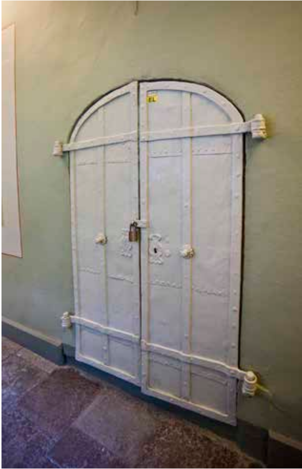
KÄLLARDÖRR AV JÄRN I UPPGÅNG 11D. FOTO J. MALMBERG.
