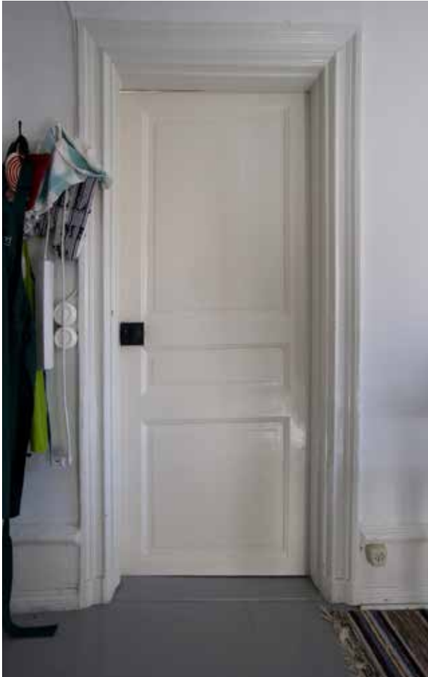
RUM MED ÄLDRE Fyllningsdörr, foder och sockelpanel från slutet av 1800-talet. FOTO: J. MALMBERG.
