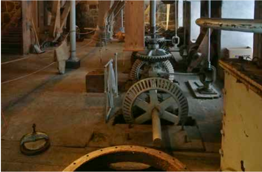
I KVARNBYGGNADENS KÄLLARVÅNING FINNS DEN VATTENTURBIN SOM DRIVER KRAFTÖVERFÖRING OCH KVARNSPEL. FOTO J. MALMBERG.
