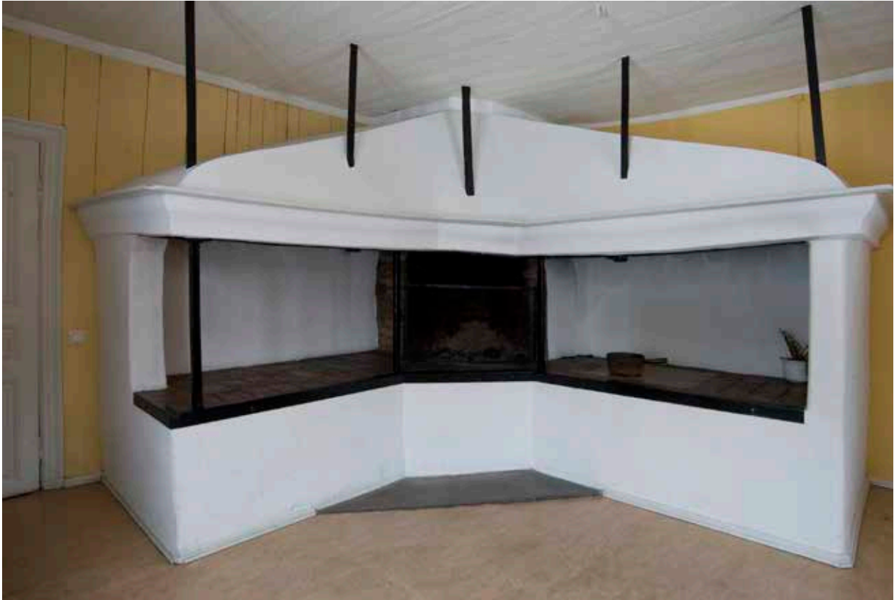
MURAD VINKELSPIS I BOSTADSFlygeln med förstärkningsjärn för att hålla upp kupan. FOTO J. MALMBERG.
