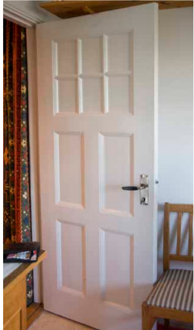
URSPRUNGLIG DÖRR MED IGENSATTA GLASRUTOR. FOTO J. MALMBERG.
